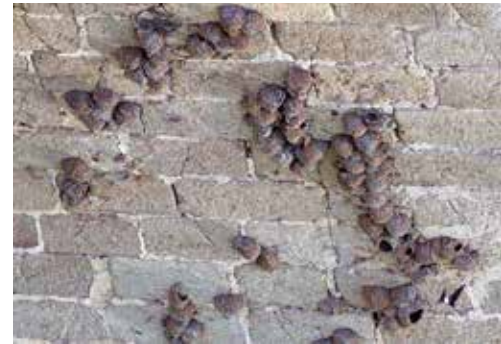
Mehlschwalbennester unter einer Brücke (Foto: Gunter Halle)
